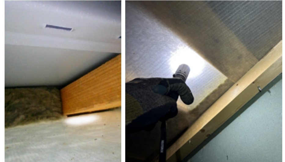
■ Kuva 10: Tasaisen peltikatteen tiivistys. Vasemmalla on näkymä alus- ja peltikatteen välistä. Oikealla sama kohta aluskatteen alapuolelta ullakkotilasta katsottuna. (J-P Laakso / SPPL).
