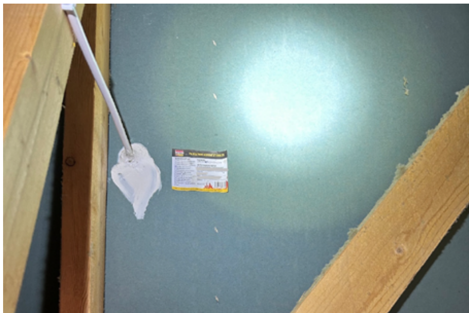
■ Kuva 16: Oikein toteutettu osastoivan rakenteen läpivienti ja merkintä. (J-P Laakso / SPPL).
