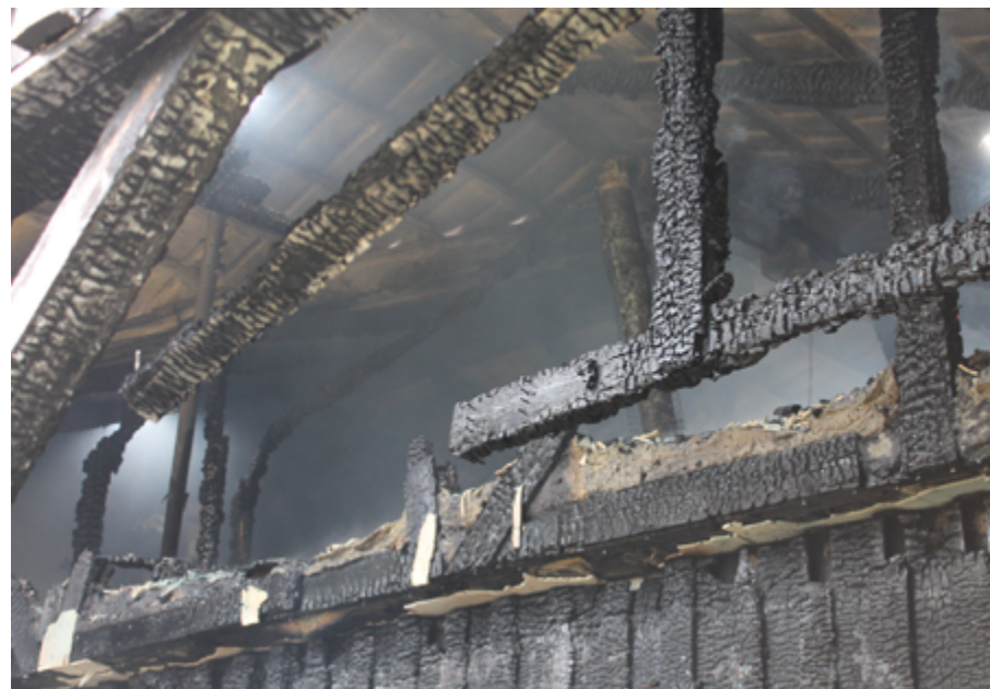
■ Kuva 1: Ullakolle päässyt tulipalo (Länsi-Uudenmaan pelastuslaitos).
