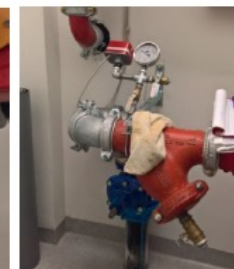
Kivenerotin & SPR-syötön alarajahälytys valvomoon (alhaisen paineen mittari)
