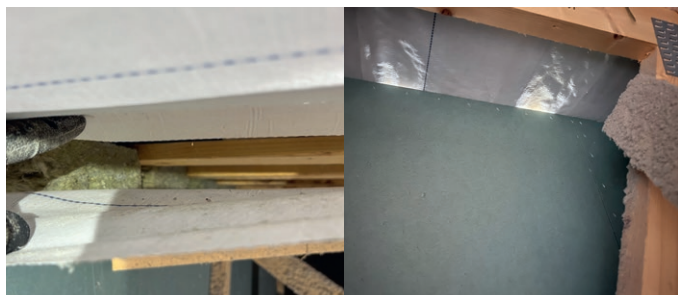
Kuva 11: Peltikatteellinen rakennus, jossa ruuteen alapinnan ja seinän väli tiivistämättä (J-P Laakso/SPPL).
