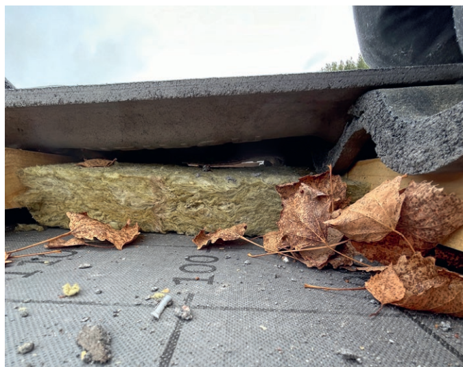
Kuva 10: Tiilikatteen tyypillinen tiivistyksen epäjatkuvuuskohta. Tiivistysvilla on lisäksi hieman liian ohut ruoteisiin verrattuna (J-P Laakso / SPPL).
