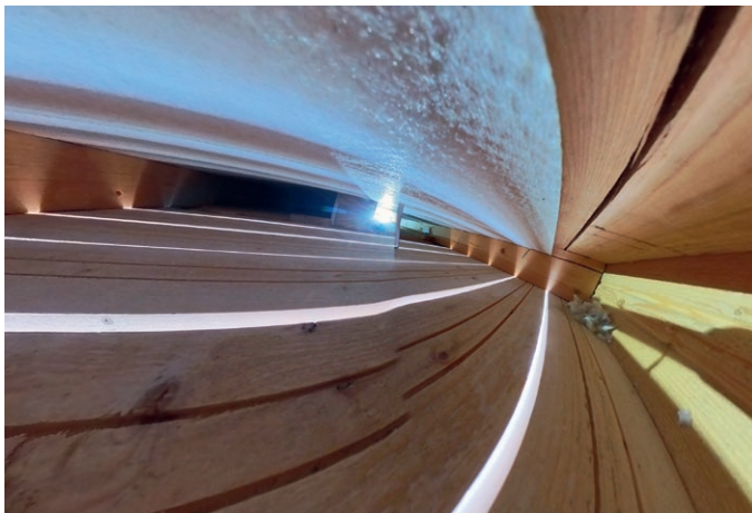
Kuva 15: Räystääskotelo, jossa osastoiva seinä (valon vasemmalla puolella) päättyy ulkoseinän kohdalle lämpörajalle. Kotelo kuvattuna 360-kameralla. Kuvassa oikealla näkyy otsalauta ja ruuheet sekä vasemmalla keskellä NR-yläpaarre (J-P Laakso/SPPL).
