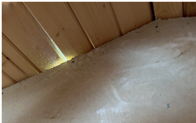
Kuva 13: Huopakatteellinen vesikatto raakaponttilaudoituksella. Toteutus ei vastaa rakennesuunnitelmaa (J-P Laakso/SPPL).
