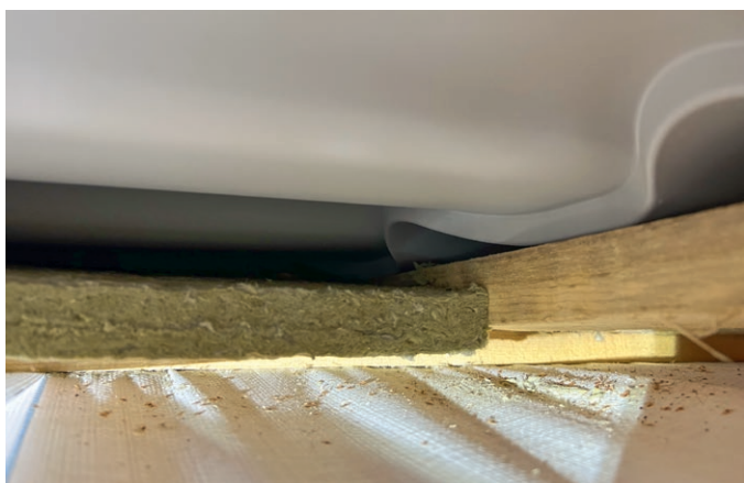
Kuva 8: Kova kivivillapala ruoteiden välissä. Kova-villa ei tiivistä seinän ja vesikaton liitosta (J-P Laakso/SPPL).
