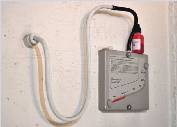
■ Ylipainemittari väestönsuojan sisällä.
