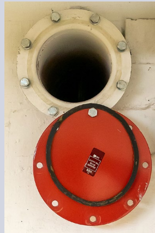
■ Ilmanvaihdon kanava, joka suljetaan, kun suoja otetaan käyttöön.
