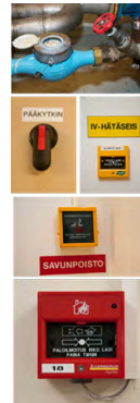
Kuva 11. Kuvissa ylhäältä alkaen veden pääsulku, sähkön pääkatkaisija, ilmanvaihton hätäseis, savunpoiston laukaisija ja paloilmoitinpainike.
