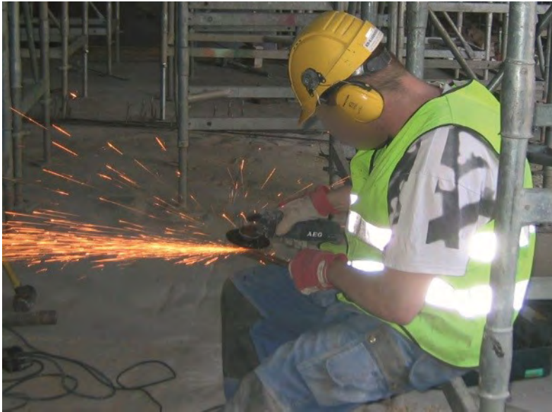
Kuva 6. Korjaus- ja muutostöihin liittyviä riskejä voidaan vähentää hyvällä suunnittelulla. Erityistä huomiota tulee kiinnittää tulitöiden turvallisuuteen.
