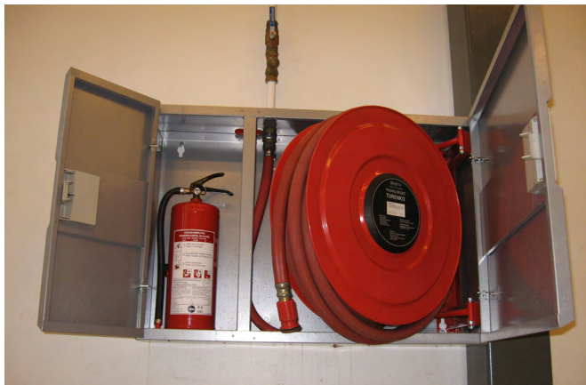
Kuva 12. Valokuvat oman kiinteistön sammutuslaitteistoista havainnollistavat käytettävissä olevia sammutuslaitteita.
