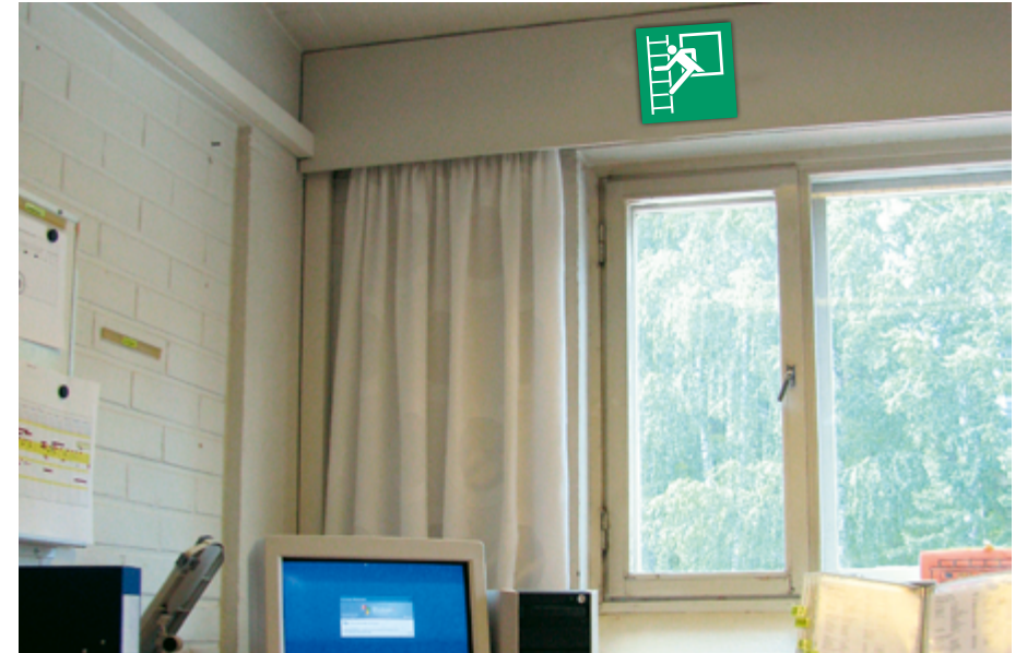
■ Kuva 24. Varatien reitillä oleva ikkuna merkitään kilvellä 2.1 tai 2.2 riippuen siitä onko ikkunasta pääsy ulkoseinässä oleviin kiinteisiin tikkaisiin vai ei. Varatieikkunan kiintopainike mahdollistaa ikkunan helpon avattavuuden.
