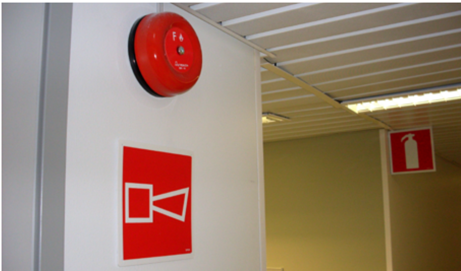
■ Kuva 23. Palohälytín merkitään kilvellä jos on vaara, että ääni sekoitetaan johonkin muuhun hälytykseen.
