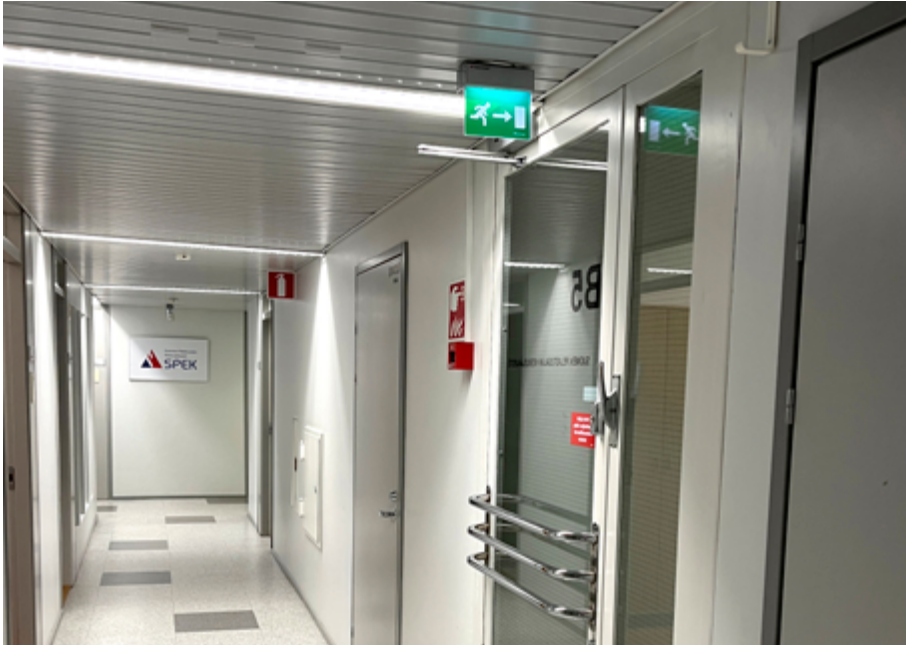
■ Kuva 15. Toimiston käytävälle asennettu opasvalaisin, jolla osoitetaan uloskäytävä.
