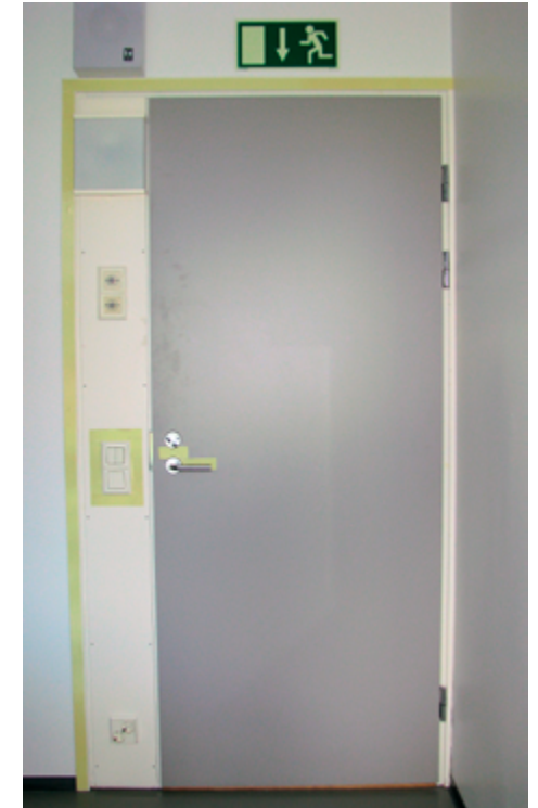
■ Kuva 20. Poistumisreitit varrella olevassa ovessa voidaan tarvittaessa käyttää tehostettua merkintää, kuten kuvan tapauksessa karmeihin, katkaisijoiden ympärille ja painikkeen kohdalle kiinnitettyä jälkivalaisevaa teippiä.
